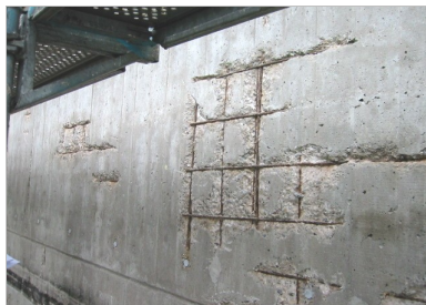
freigelegte korrodierte Bewehrungslage
